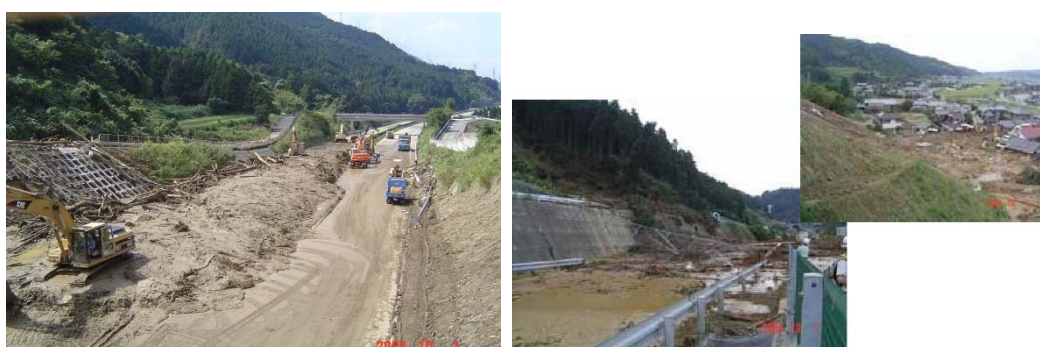
写真-6.1.3 松山自動車道の被災状況 (香川大学平成16年台風災害調査団報告書) 2)
