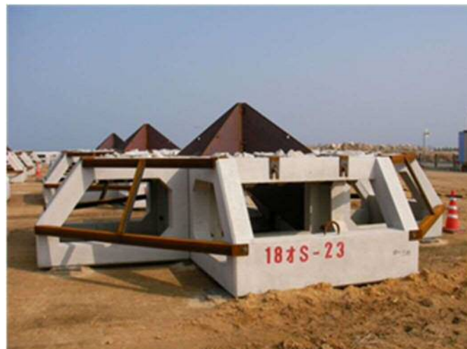
写真-2.1.1 攪拌機能を有する構造物
